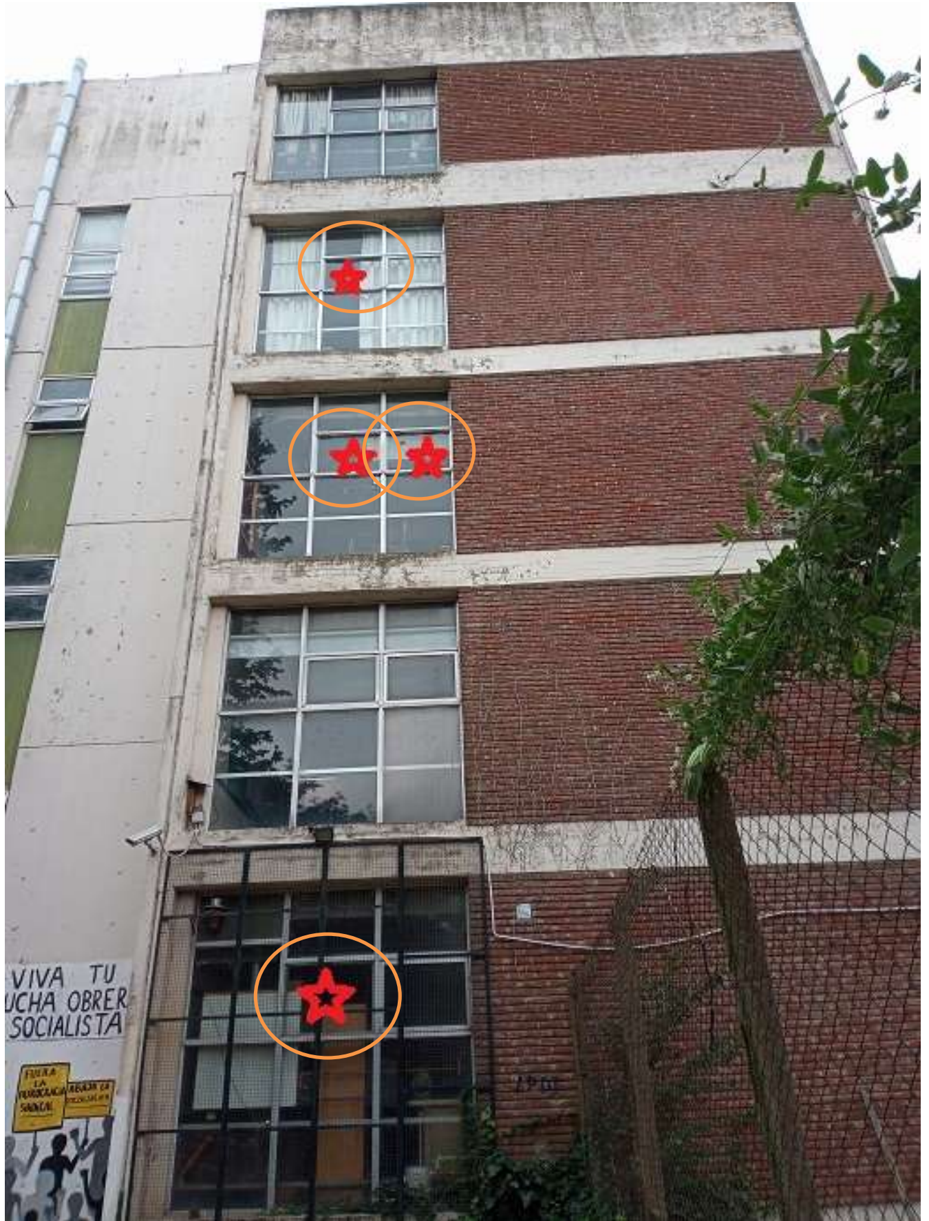
4 Ventanas a Reponer en fachada calle Peña
